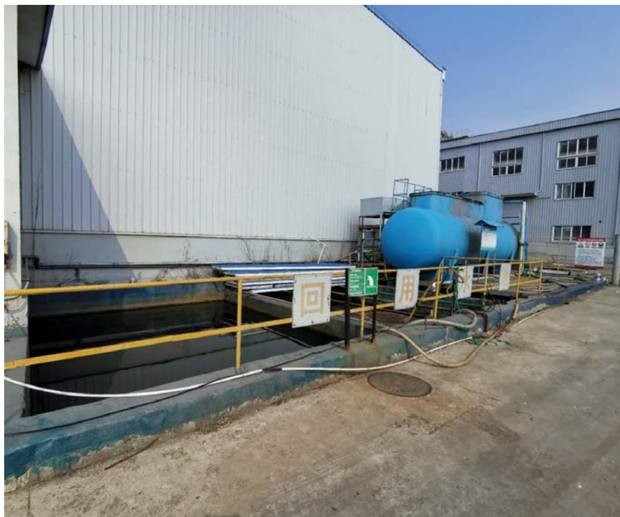
图 5.3-1 拟建项目依托污水处理设施（罐为 MBR 一体化设备，下面为生产废水处理站）
