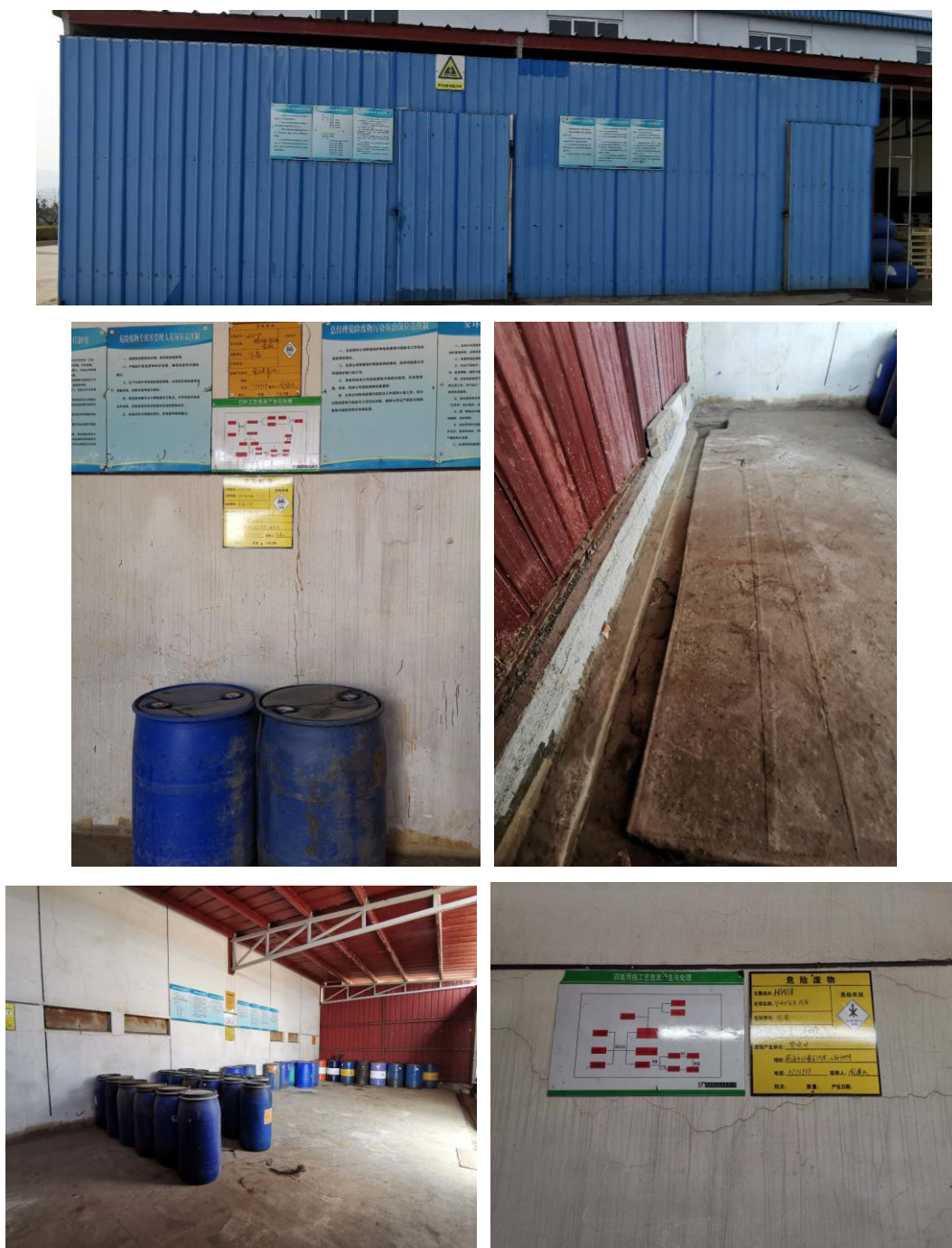
图 8.1-1 新元化工危险废物暂存库图片
