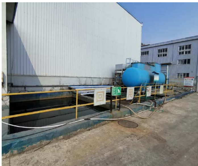
图 10.3-1 拟建项目污水处理设施（罐为 MBR 一体化设备，下面为生产废水处理站）
