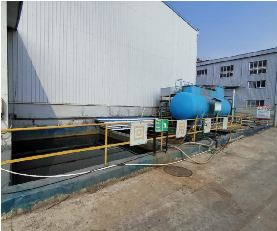
图 2.5.3-1 拟建项目依托污水处理设施（罐为 MBR 一体化设备，下面为生产废水处理站）
