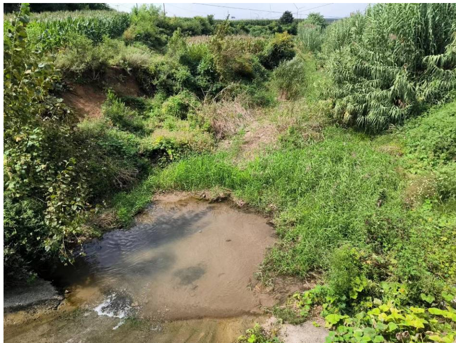
河道淤积、边坡损毁
