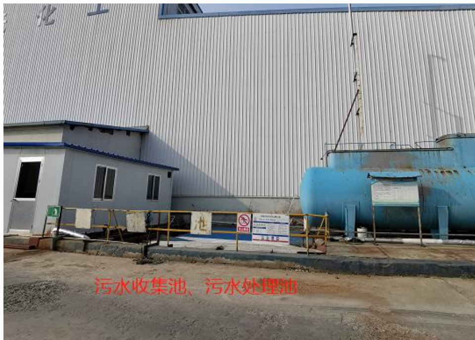
图 4-2 污水处理站现场照片
