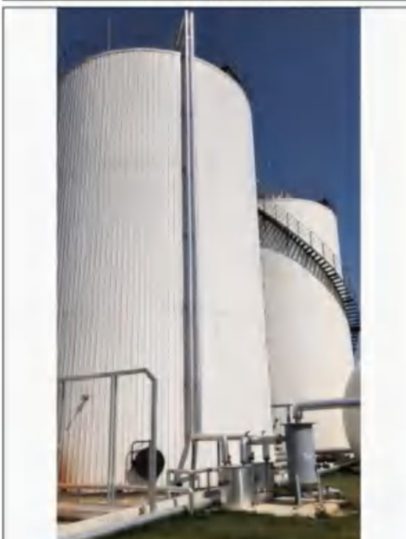
渗滤液处理站厌氧塔
