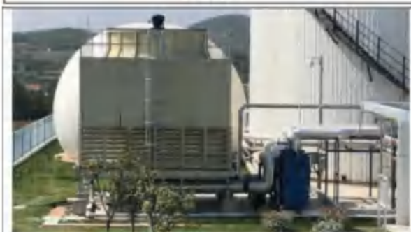
渗滤液站冷却塔
