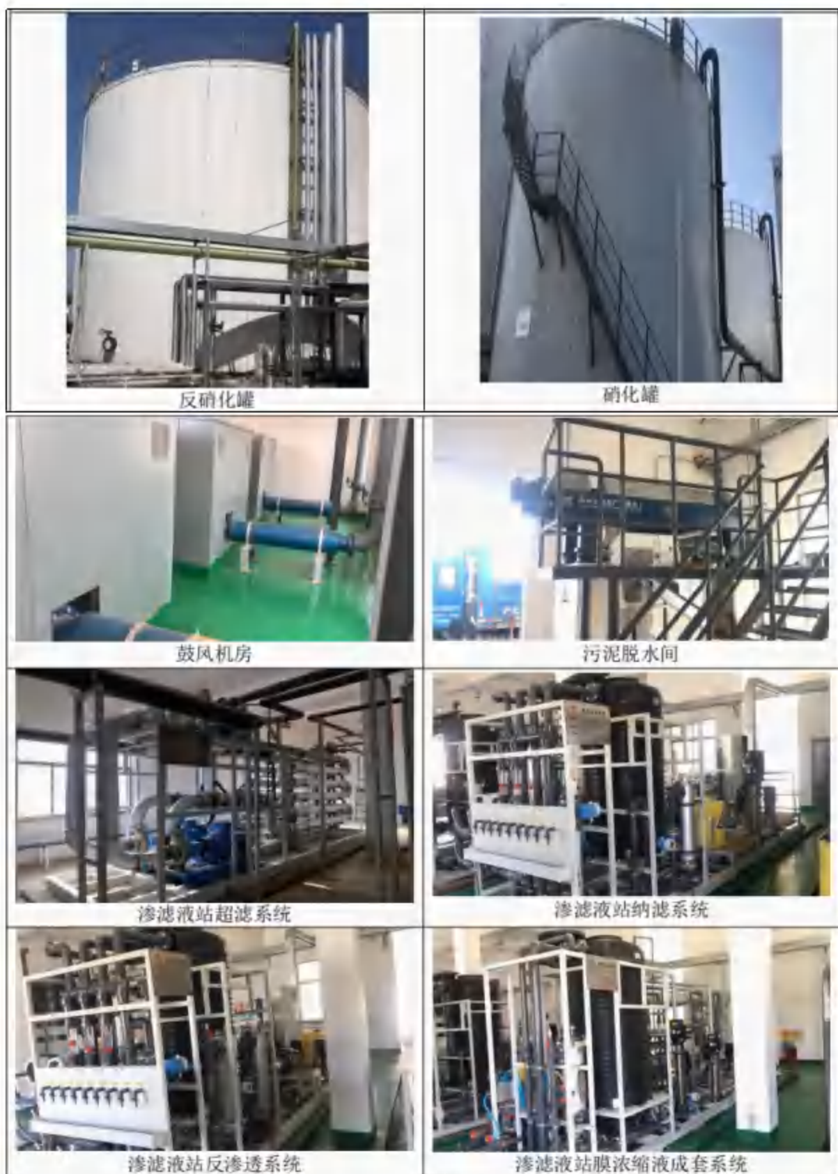
图2.4-2主要废水处理系统环保设备
