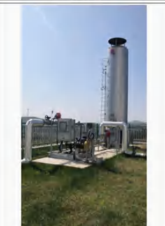
渗滤液处理站火炬
