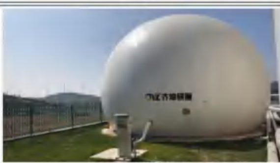
渗滤液站沼气储柜
