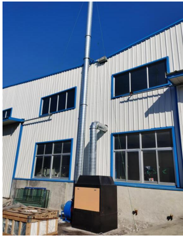
废气治理设施+排气筒
